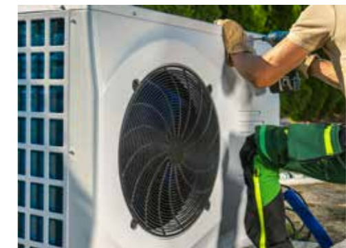
Beispiel einer Wärmepumpe
